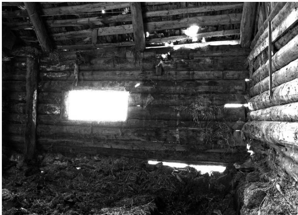
Vaade lõunaseinale enne demonteerimist: sokkel on lagunenu, seinapalgid välja vajunud, lae all valitseb vamm. Katuse raskus on surunud sarikad läbi mitme pehastunud palgirea. Loomad on seinapalgid ära närinud. Laetalad on sisse varisenud.
