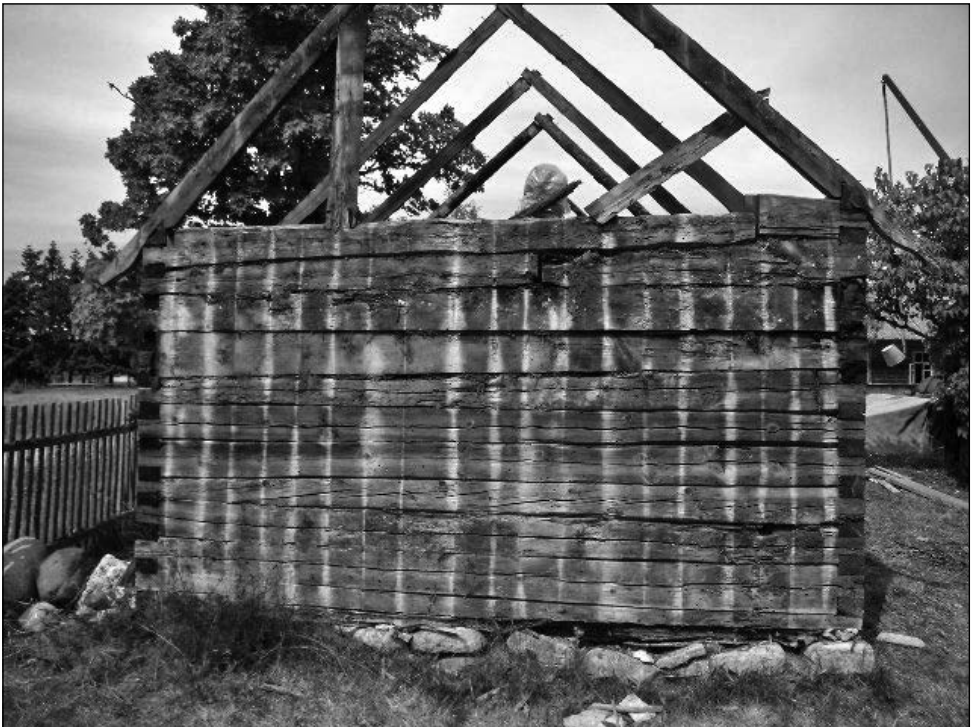
Tooma talu saun-suveköök-sepikoda enne demonteerimist: lõunasein on päikese ja ilmastiku mõjul pehkinud, seintes on hulgaliselt vanu putukkahjustusi, puit on pesuvee tõttu pehkinud ja sokkel ära vajunud.
